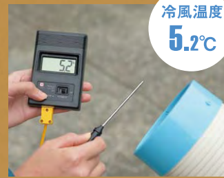
スポットエアコンの吹き出し温度は 5.2°C。
